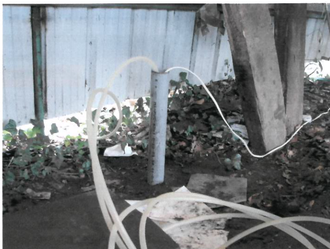
Figure 5 : Forage équipé d'une pompe pour le prélèvement d'eau
